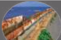
塩害の影響でさびたガードレール
